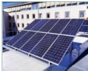
Fotovoltaikanlage am Haus der Stadtwerke.
